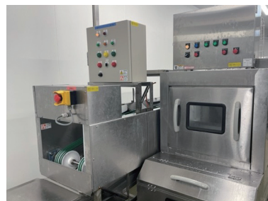
食堂設置 / 節水食器洗浄機の導入
